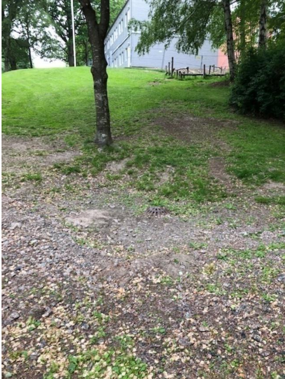
Figur 32. Brunn på fastighet i slänten ner mot dagvattendamm. Verkar fungera bra, bildats som en kant runt brunnen som kan fördröja en liten mängd vatten.
