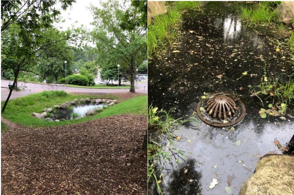
Figur 7. Dagvattendamm på skolområdet som har brunn ut i dagvattenledning i Danska vägen.
